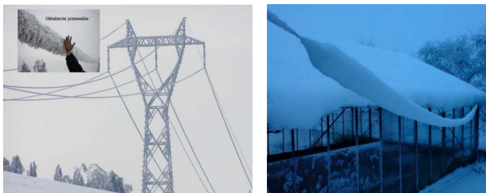
Rys 12.5. Oblodzenie i sadź na przewodach i elementach konstrukcyjnych linii napowietrznych [13,14]
