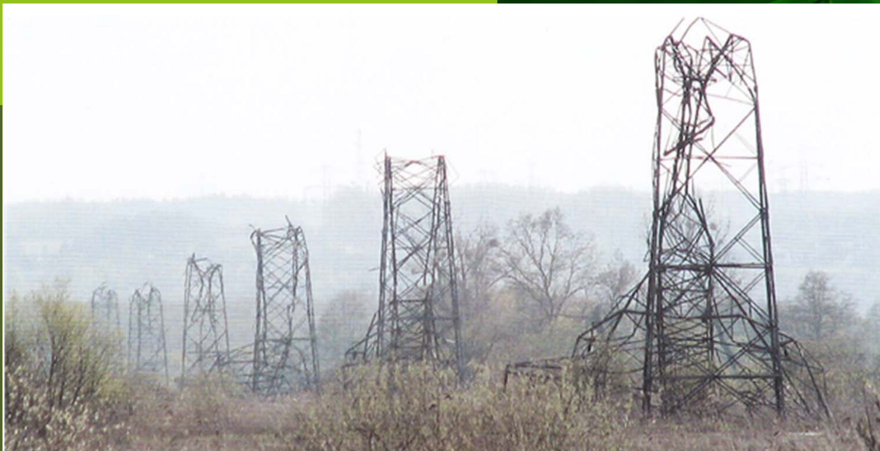
Rys 26. Zniszczona linia 220 kV w wyniku obfitego opadu mokrego śniegu, okolice Szczecina 8 kwietnia 2008 r.
