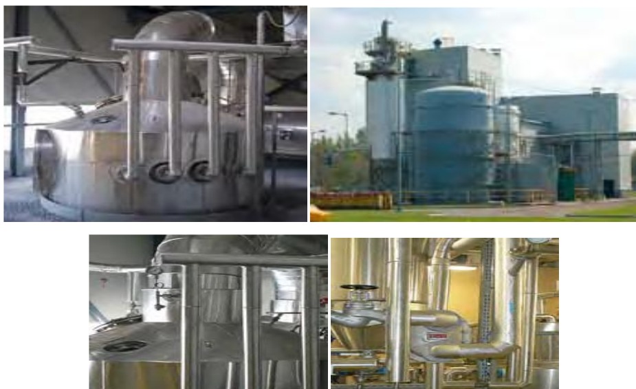
Rys.4.4 Instalacja z krystalizacji [Źródło: materiały udostępnione przez firmę Baterpol]
